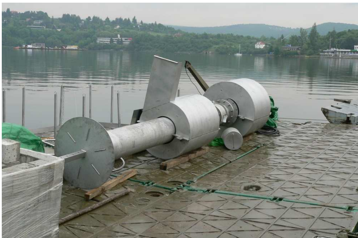
Aerační věže měří téměř deset metrů
