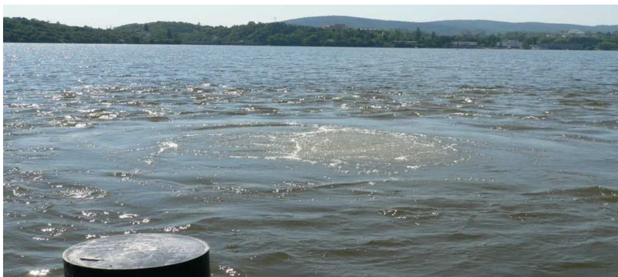
Aerační systém vodní nádrže
